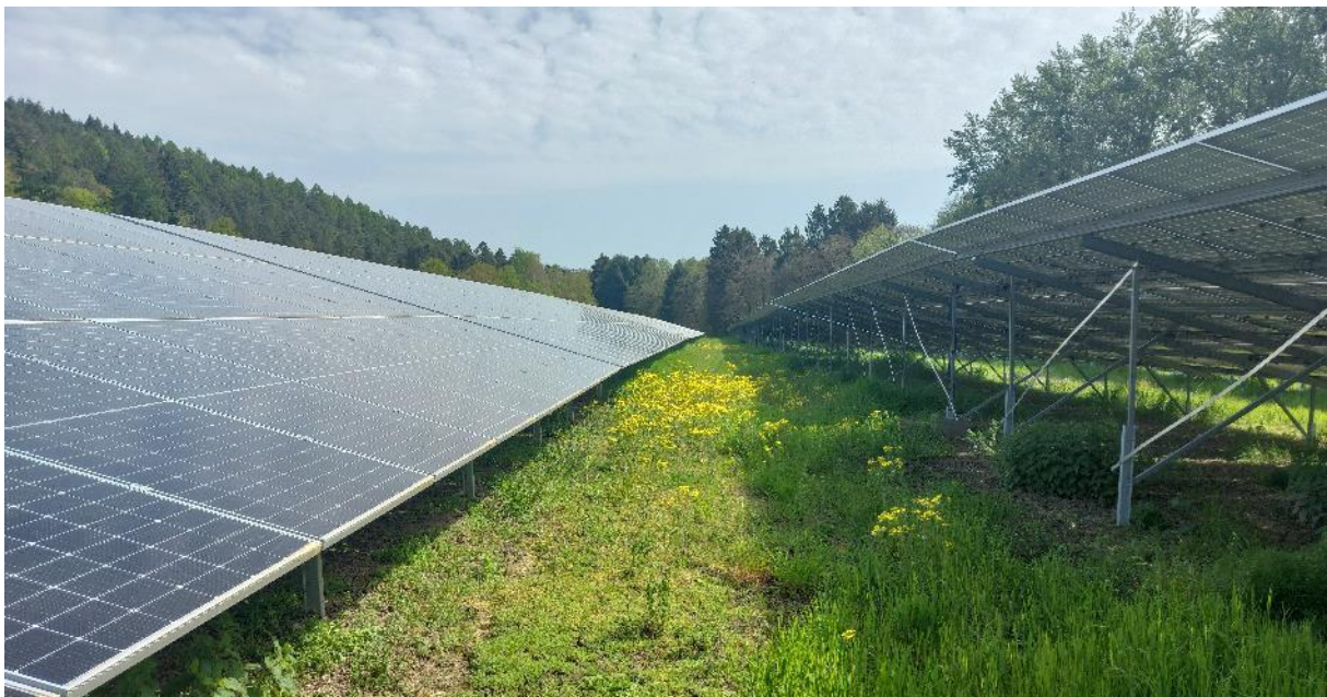
Abbildung 4-25: Zwischenraum zwischen den Modulreihen am Beispiel der PVA Nunkirchen, Saarland
