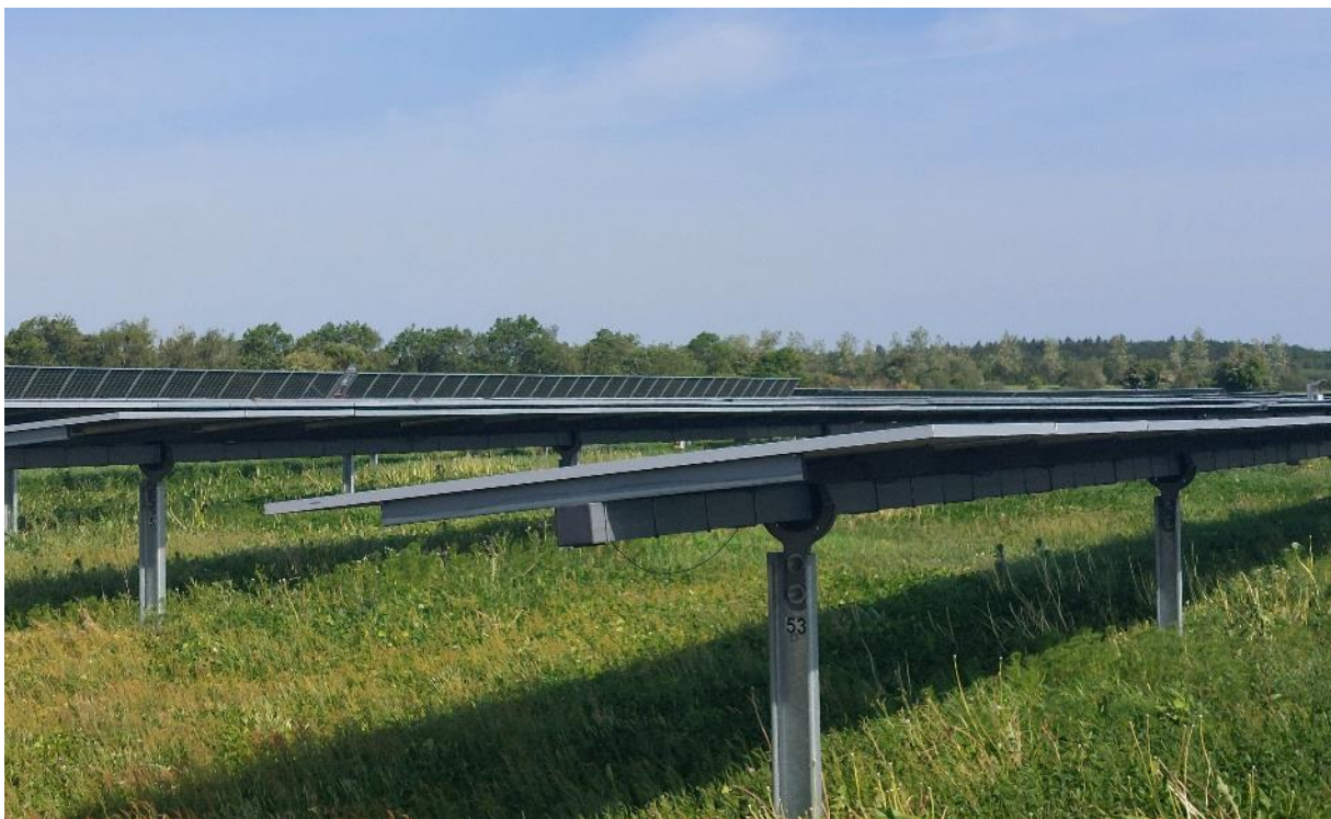
Abbildung 4-27: Detail der Trackinggestelle in der Anlage bei Ringkøbing
